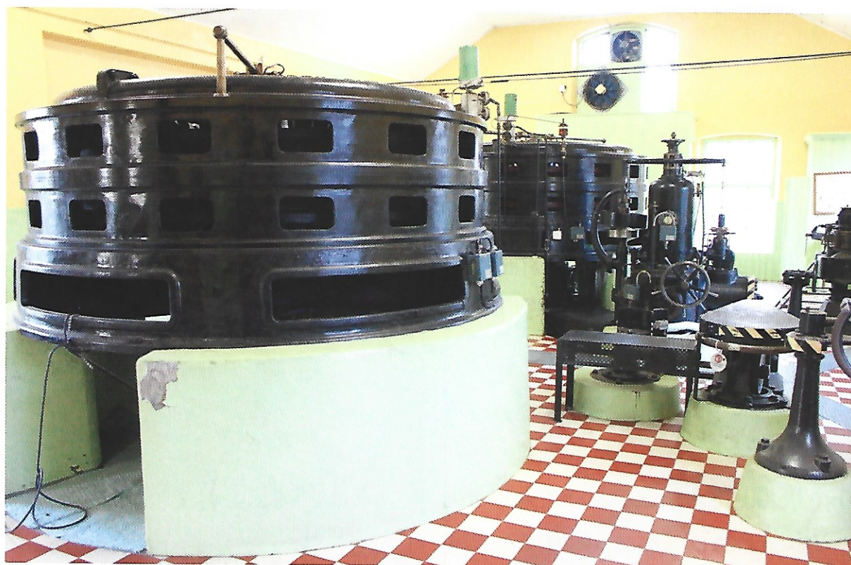
De två äldsta generatorerna
